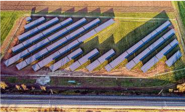
Die PV-Anlage »Brächle« aus der Vogelperspektive: Dieses beeindruckende Foto erstellte Edwin Häufle aus Mühlhausen-Ehingen mit Hilfe einer Drohne und stellte es dem HegauKurier freundlicherweise zur Verfügung. Bild: Häufle
