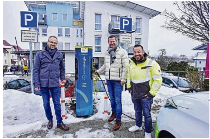
Neue öffentliche E-Ladestation in Mühlhausen-Ehingen: Thomas Sauter, Kommunalbetreuer, Bürgermeister Patrick Stärk und Projektleiter Giuseppe Castiglione bei der Eröffnung (von links).
