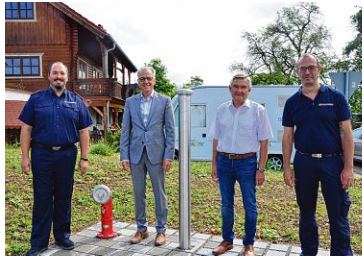
Der stellvertretende Kommandant der Abteilungswehr Biesendorf, Lars Anhorn, Bürgermeister Johannes Moser, Ortsvorsteher Reinhold Mayer und Feuerwehrkommandant Markus Fischer (von links) freuen sich über den neuen Löschwassertank.
